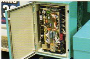
防水ボックスに収納されたI/O基板
